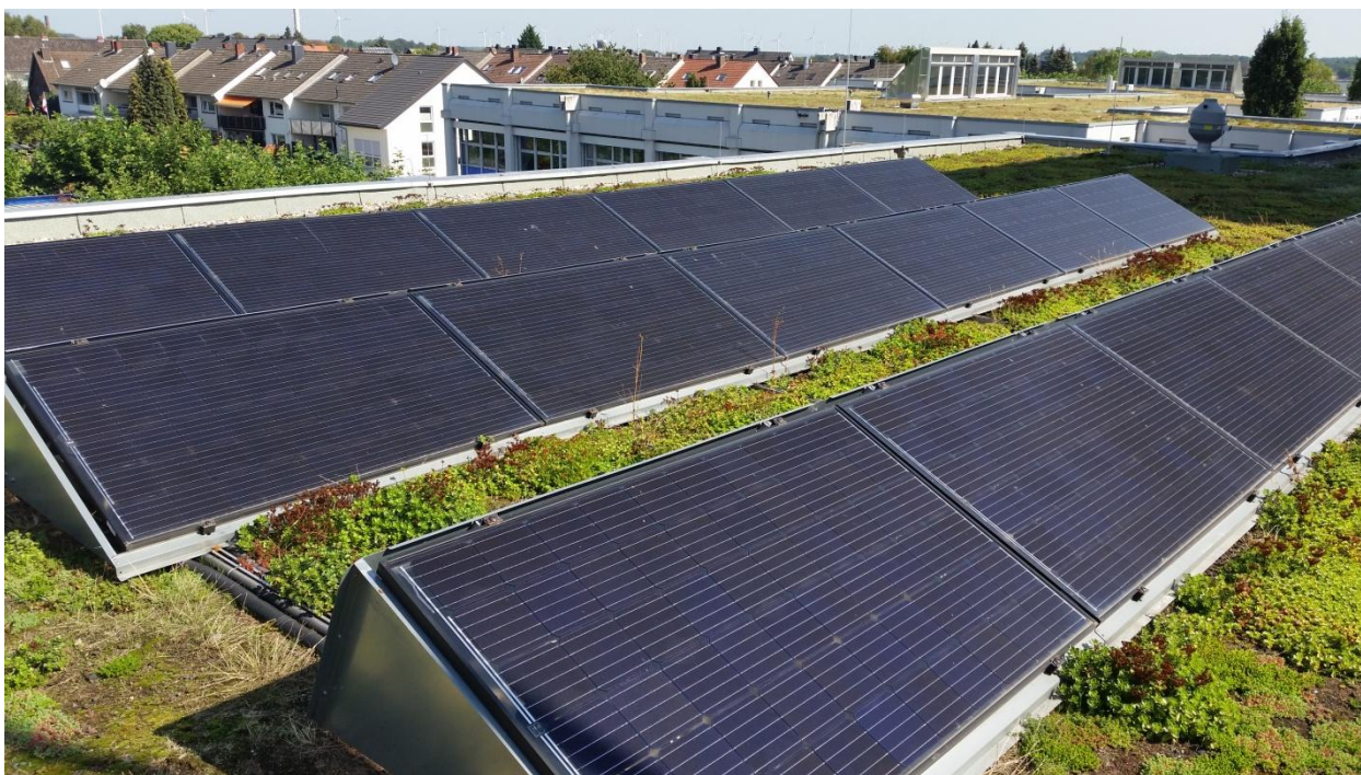
Рис. 3 – солнечные батареи на крыше университета
