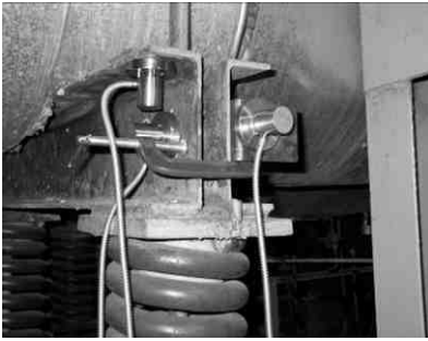
Рис. 1. Датчики вибрации, установленные на пружинную опору трубопровода
